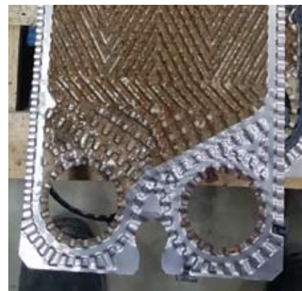
Налет на пластине теплообменника в контуре градирни
