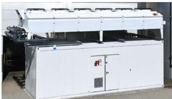
Внешний вид контейнерной установки
