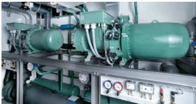
Контейнерная установка (вид изнутри)
