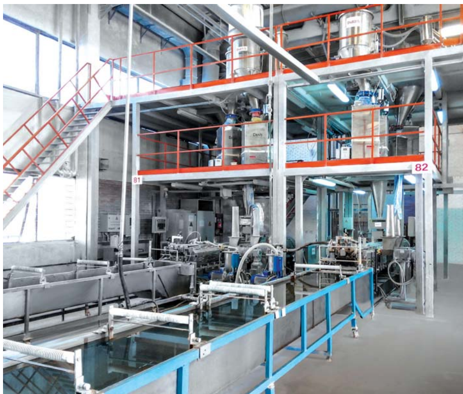
Двухшнековые экструдеры Coperion STS 75, установленные на производственной площадке НПП «ПОЛИПЛАСТИК» в Тольятти (фото: НПП «ПОЛИПЛАСТИК»)
